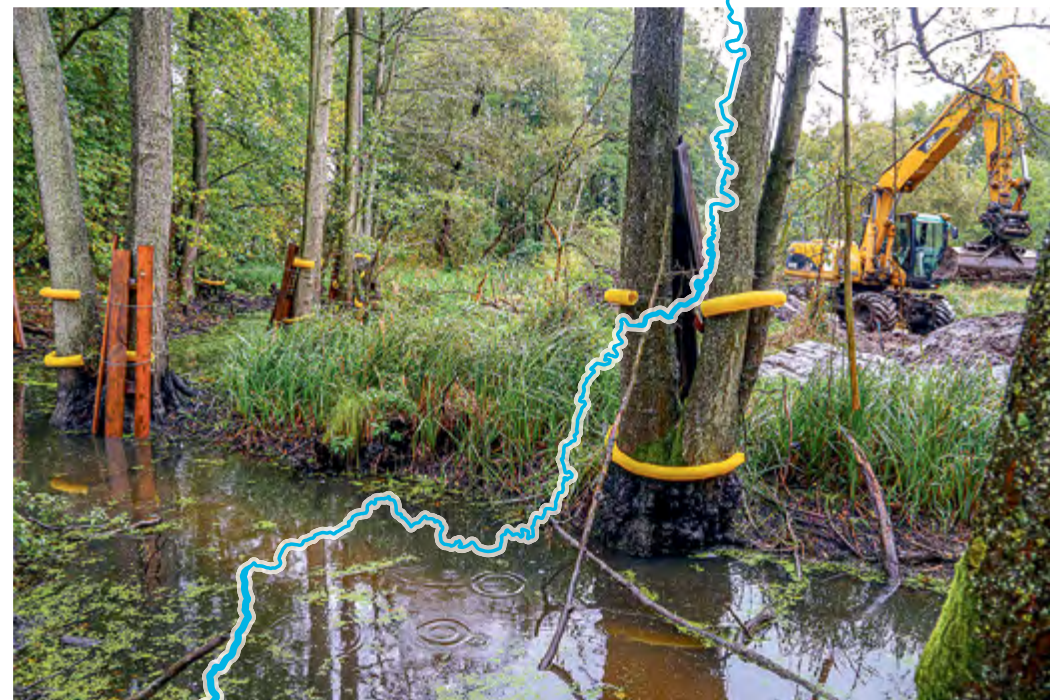
Mit schwerem Gerät wurde an der Stepenitz gearbeitet, um das ursprüngliche, natürliche Flussbett zu reaktivieren.
