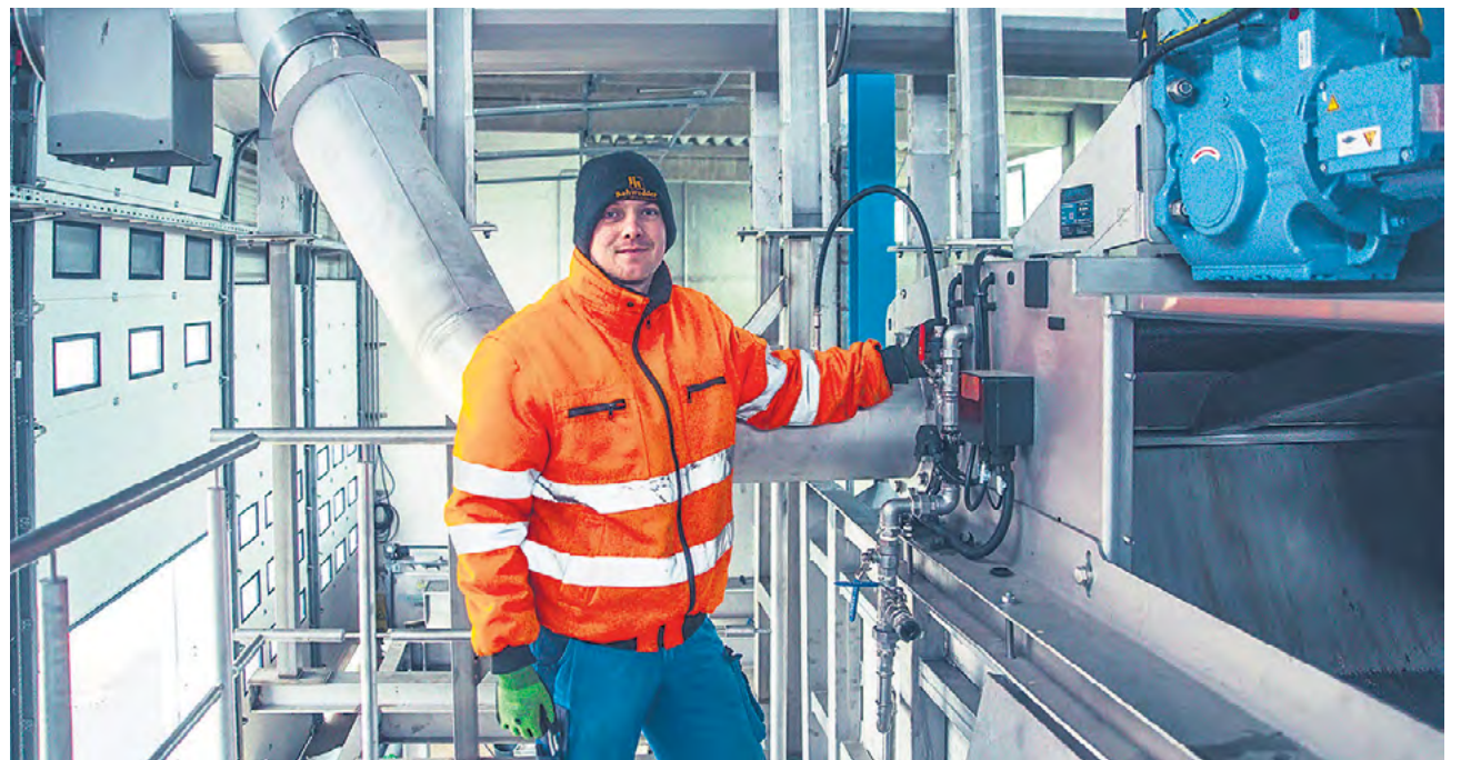
Abwassertechniker Artur Hampel an einem der beiden neuen Feinrechen.
