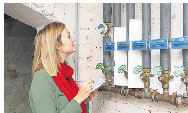
Dreht sich das Rädchen vom Wasserzähler, obwohl alle Hähne zu sind? Dann gibt es ein Leck. Ein regelmäßiger Check verhindert unnötigen Wasserverlust.
