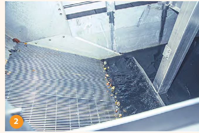
Eine Harke fischt im Feinrechen Grobstoffe aus dem Abwasser.
