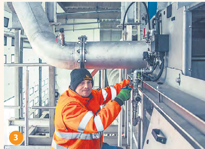
Abwassertechniker Artur Hampel prüft am Feinrechen die Abläufe.
