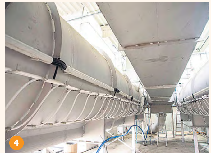
Die beiden neuen Walzensandfänge sorgen für das Herausfiltern des Sandes aus dem Abwasser.
